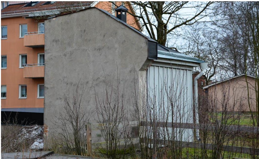
Uthusets slammade fasad ut från fastigheten.
